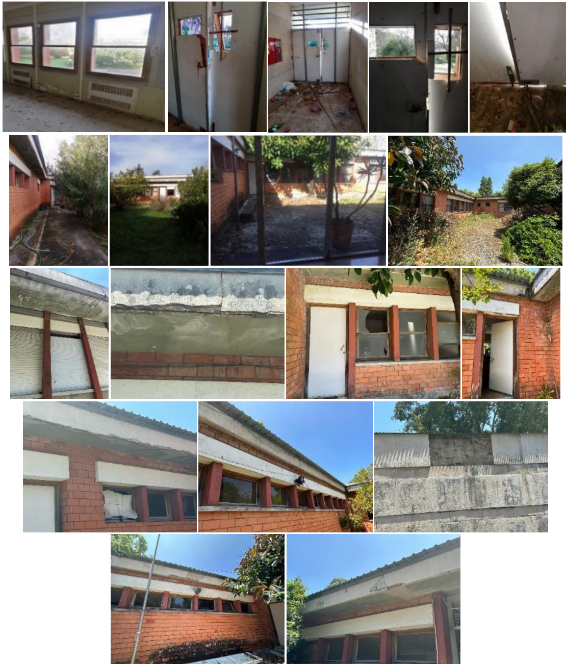
Pormenores das alas desocupadas do edifício do Palácio da Justiça de Rio Maior
