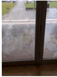
Pormenor da entrada do Palácio da Justiça de Rio Maior, em dias de precipitação
